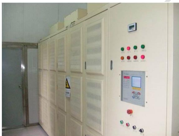
高压变频调速系统现场运行图
