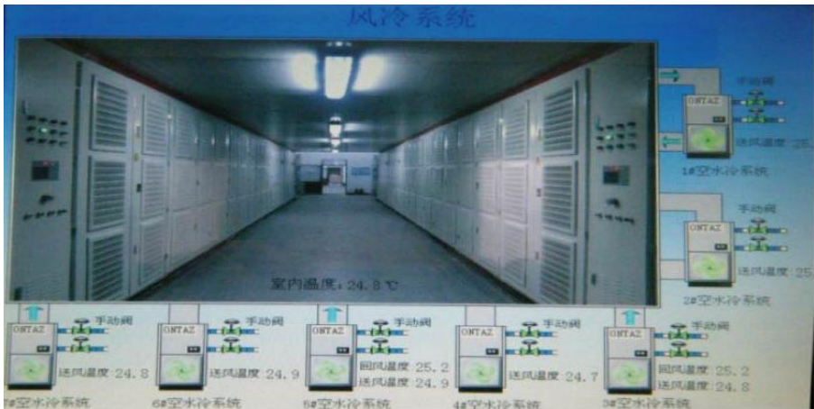
高压变频器室冷却系统
