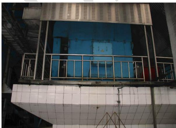
高压变频调速系统控制的引风机图
